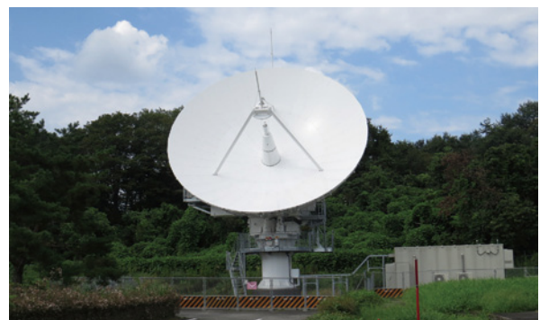
2020年稼働予定の新型パラボラアンテナ
