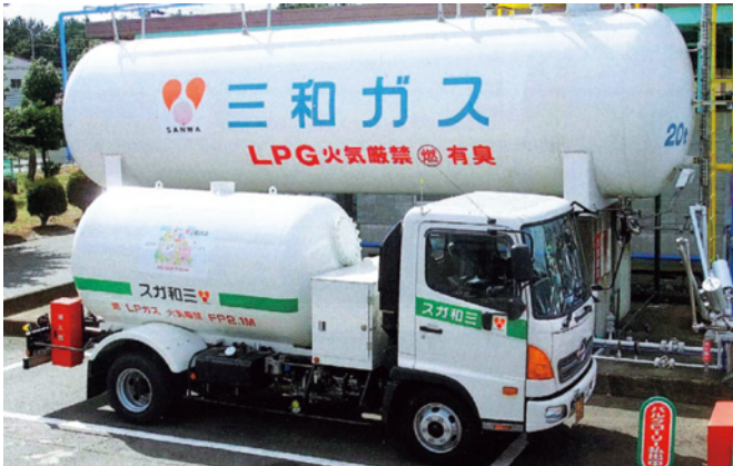
筑波事業所内 LPガスプラント及びLPガスローリー車
