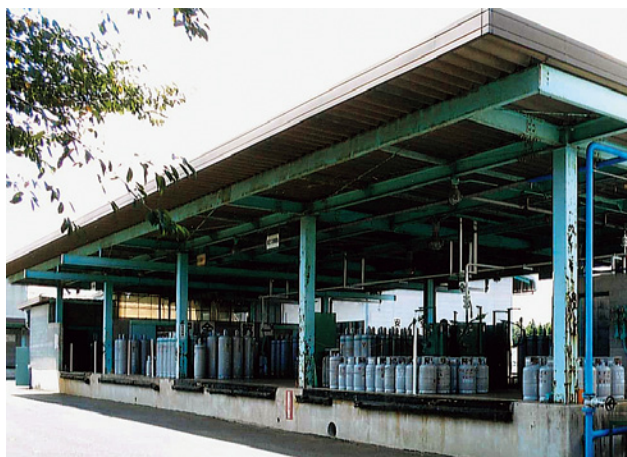
筑波事業所内 LPガス出荷プラットフォーム
