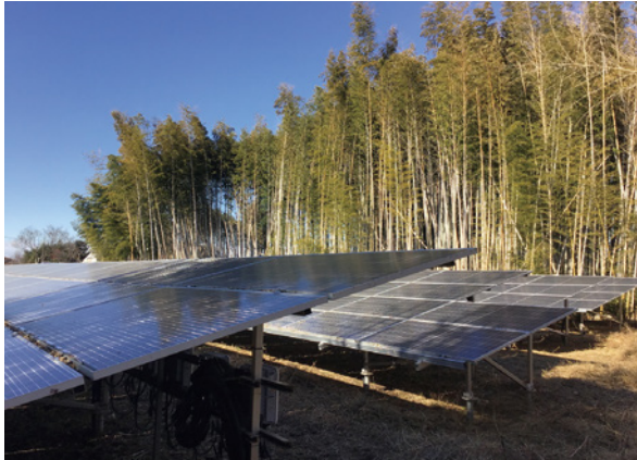
太陽光パネルを設置した太陽光発電所
