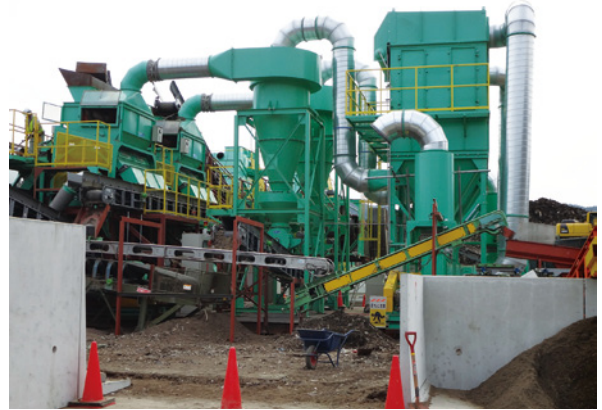
比重差選別機 SHB-25 全景（建築廃材選別設備）
