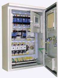
浄化槽制御盤
