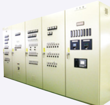
農業集落排水処理設備動力制御盤
