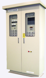
排水処理設備動力制御盤
