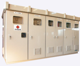
高圧受変電設備
